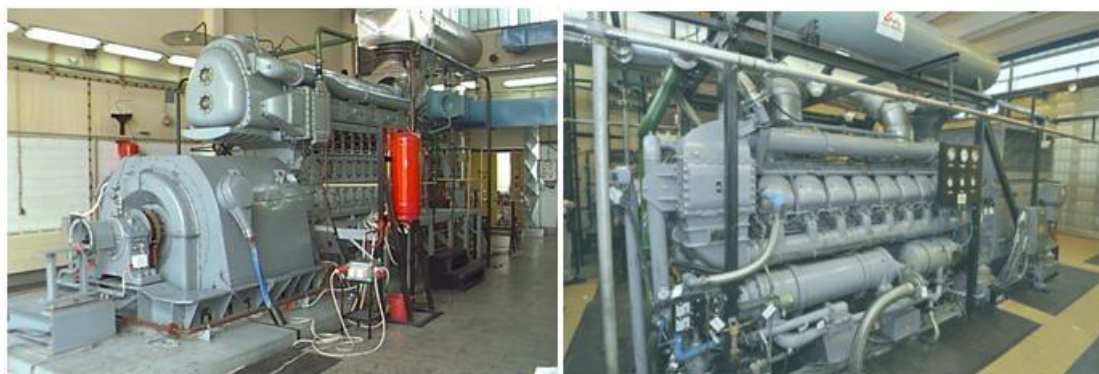
1-13. ábra: Az I. és II. kiépítés dízelgenerátorai
