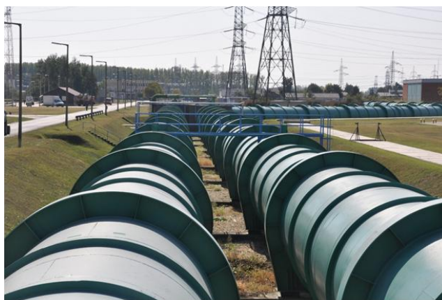
2-7. ábra: A kondenzátorhűtővíz-rendszer udvartéri csővezetékei
